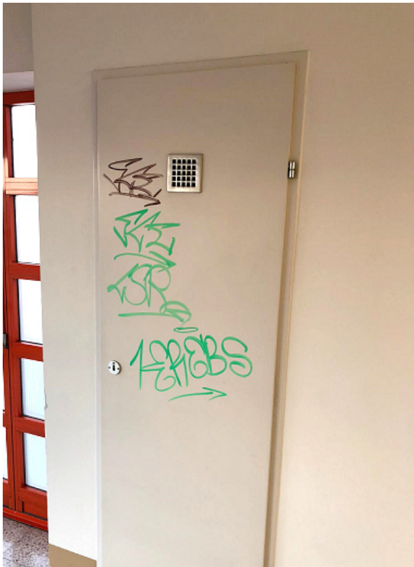
Sinnlose Schmierereien im Stiegenhaus - kaum entfernt, sind sie wieder da
